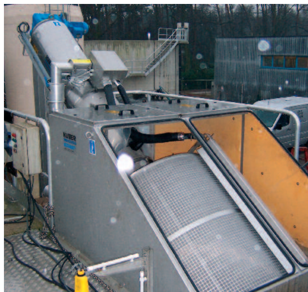
Installation utomhus med skyddsluckor och isolerat spolvattenrör
